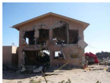
津波による排水機場の被災
