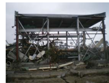
大堀排水機場(仙台市)被災状況
