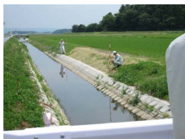
応急復旧を行った水路法面の災害査定状況(登米市)
