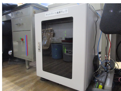
騒音漏れが発生していた機器
