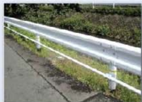
ガードレール
